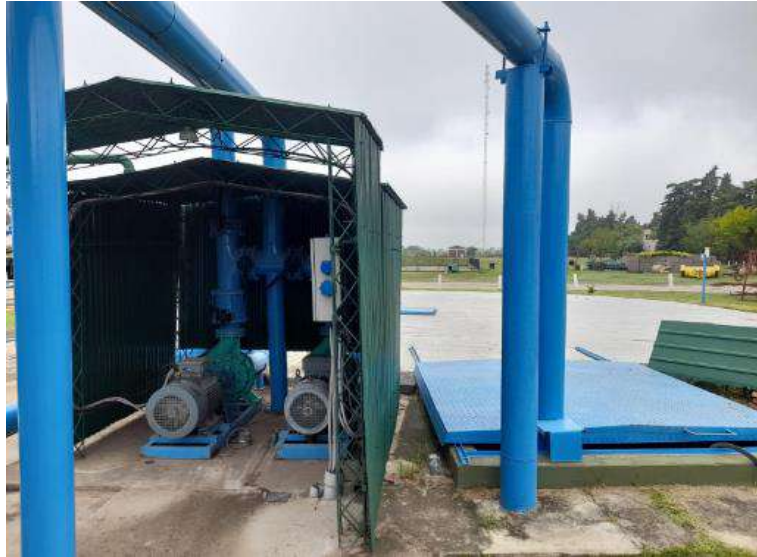
Figura 40 – Sistema de bombeo de agua tratada existente – Imagen brindada por Virginia Pacini
