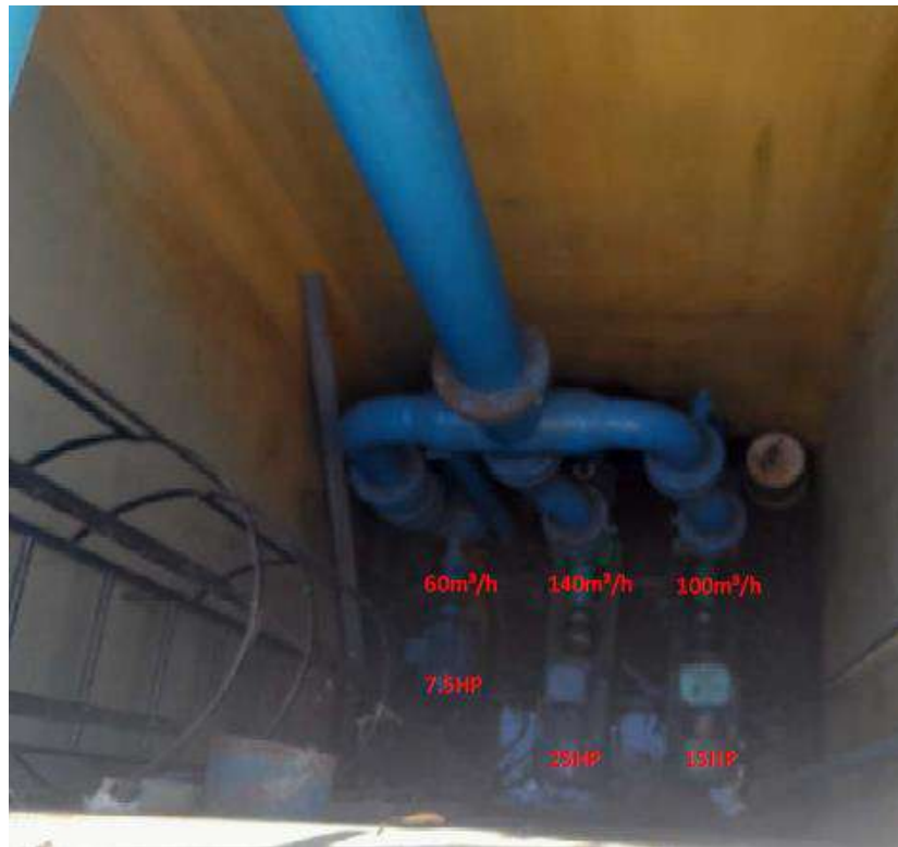
Figura 38 – Sistema de bombeo de agua cruda existente – Fuente de elaboración propia
