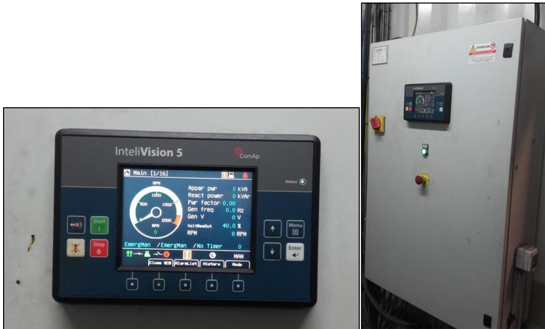
Figura 9: tablero eléctrico de la unidad de generación y pantalla HMI.
