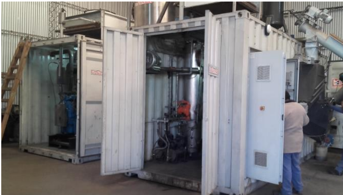
Figura 22: Módulos 2 y 3 del equipo de gasificación analizado
