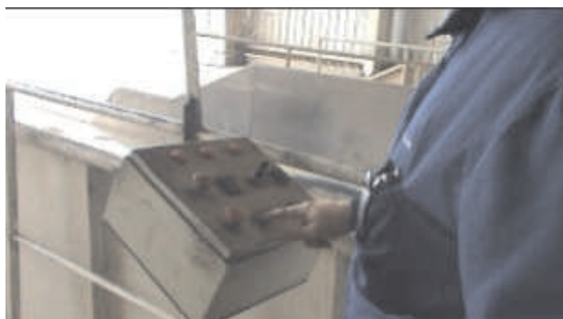
Fig. 3. Tablero para manejar la plataforma volcadora de acoplados
