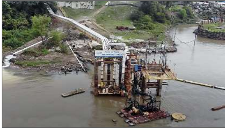
Fig 9a. Imagen tomas de captación A y Suplementaria (PPR)
