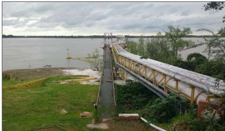
Fig 9b. Imagen acceso a tomas de captación y cañería conducción (PPR)
