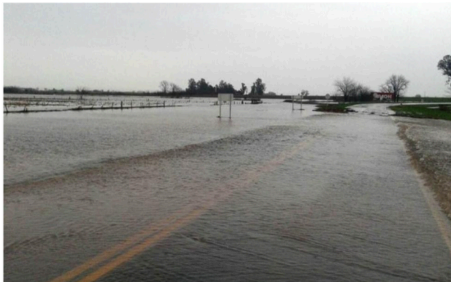
Fig. N°4.3. Noticias de cortes por inundación del tramo en estudio.
