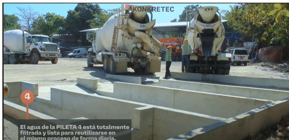
Figura 7.3.4.3 Pileta de lavado típica de planta hormigonera.
