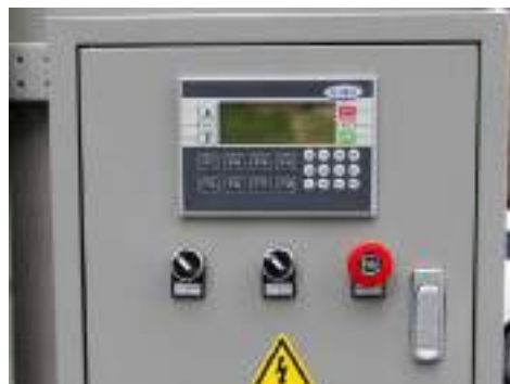
Figura 5-11: Controlador PLC para automatizar la operación.
