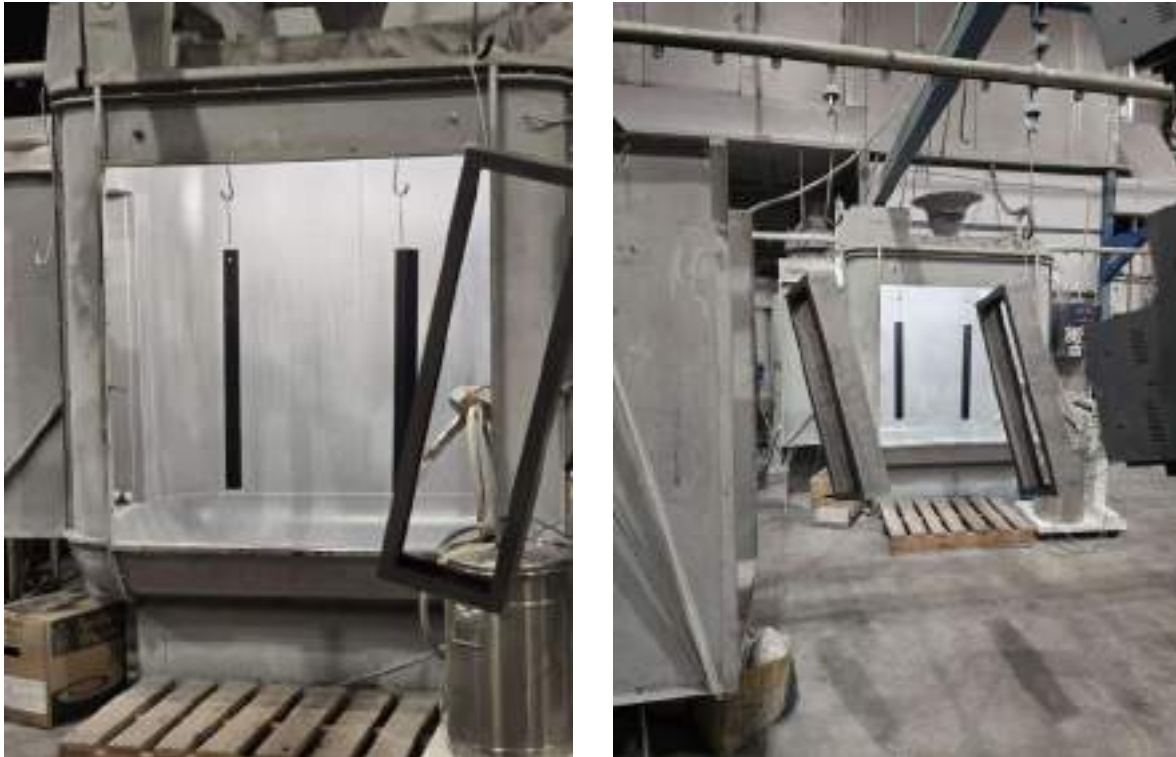
Figura 2-6: Cabinas de pintura.
