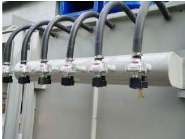
Figura 5-8: Inyectores de aire para limpiar los filtros.
