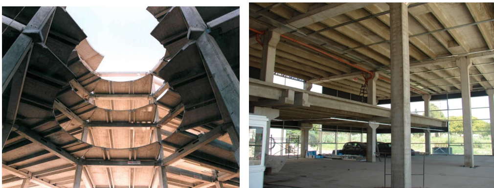
Ilustración 14 – Edificaciones con entrepisos de Astori. Fuente: Astori Estructuras S.A. (n.d.). Fotografías [Conjunto de fotografías de las obras realizadas con entrepisos de Astori]. Recuperado de https://www.astoriestructuras.com.ar/sistemas/entrepisos .
