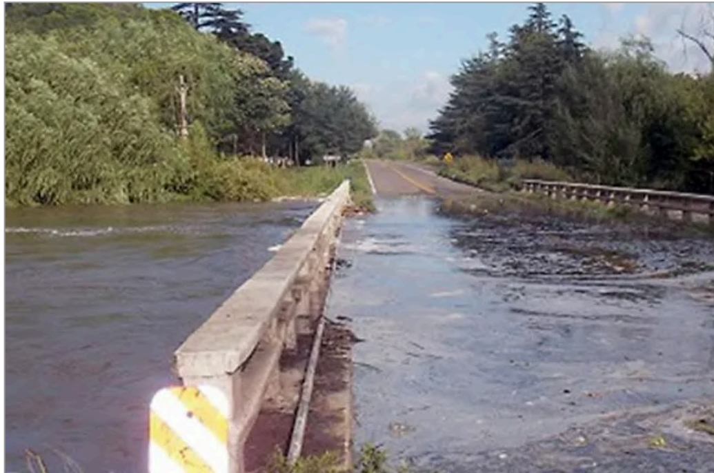
Figura 4.4. Anegamiento del puente ubicado sobre la ruta 9. (2015).
