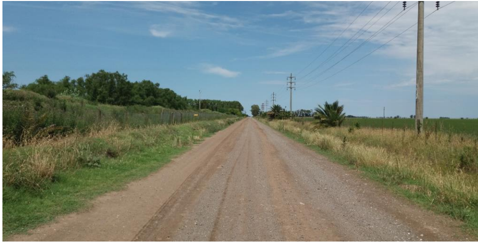
Figura 36: Problemas de escurrimiento transversal, Tramo A01 (08/20). Elaboración propia
