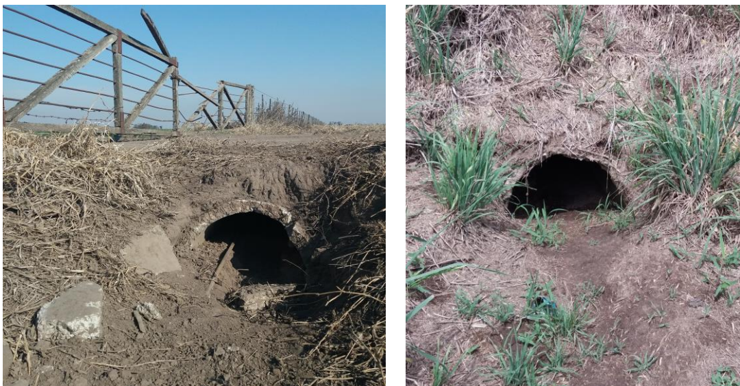
Figura 35: Alcantarillas en mal estado, Tramos A02 y B001 (08/20). Elaboración propia
