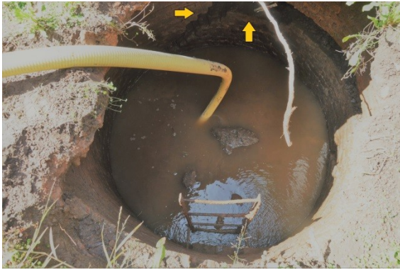
Foto 3: Vista de la escalera y de la fractura del pozo
