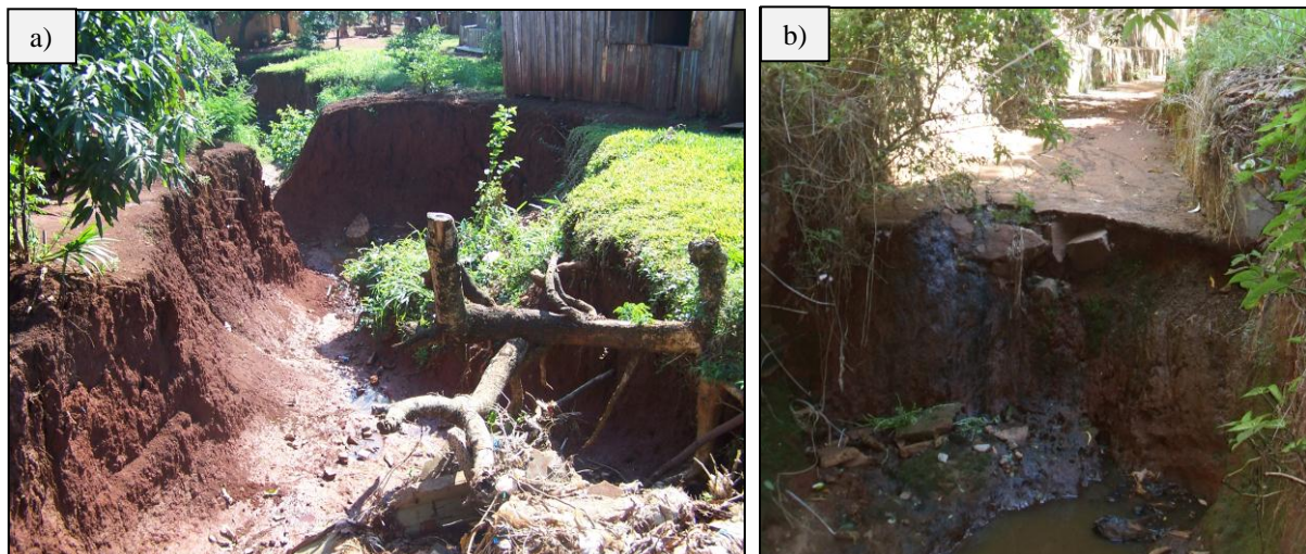
Figura 1.3.a. Cauce natural erosionado. b. Ollas al pie de obras de canalización.
