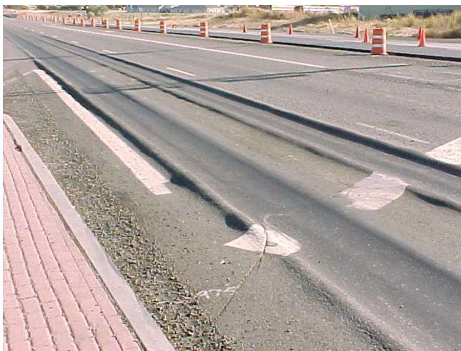
Figura 2. Deformación de calzada debido al tránsito pesado.
