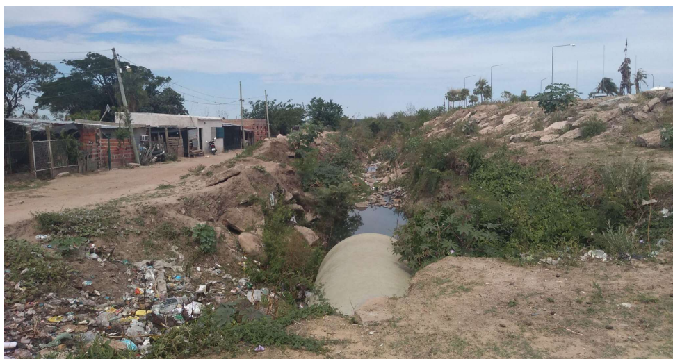
Figura 5.10: Asentamiento Bajo Caridi junto a canal aliviador del entubado del Arroyo Limita que finaliza en zanja contaminada. Fuente: Elaboración propia, 2020.
