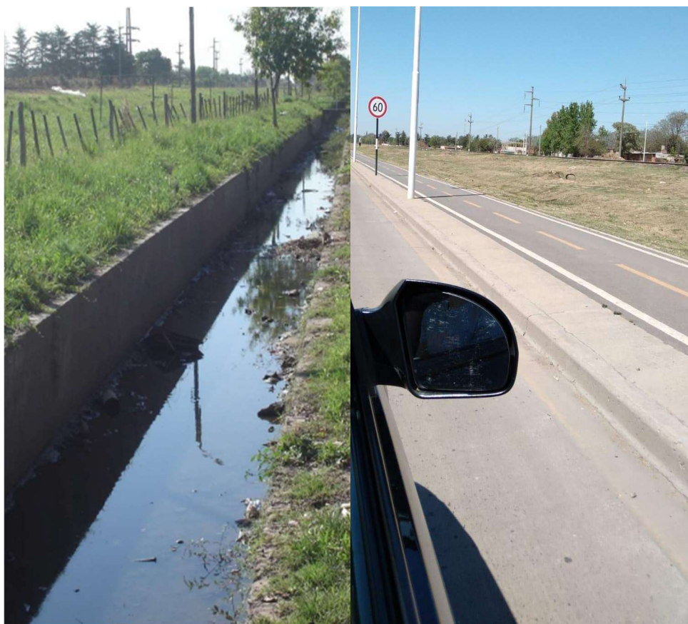
Foto 10 - Canal Belgrano en 2016 a la izquierda y en 2022 a la derecha. Sentido Norte-Sur desde la calle Santa Fe hasta la avenida Crisantemos.
