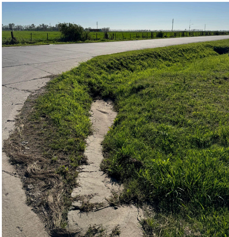
Imagen 10. Cunetas del PIR con vegetación densa. Fuente: elaboración propia.
