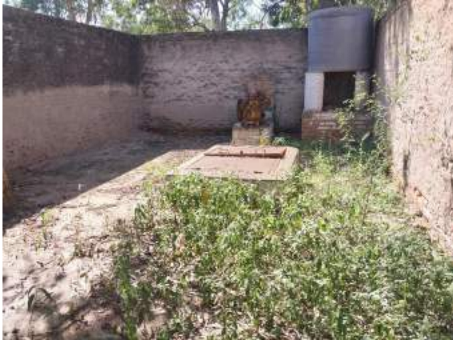
Foto 1 - Pozo de Bombeo N°1.
