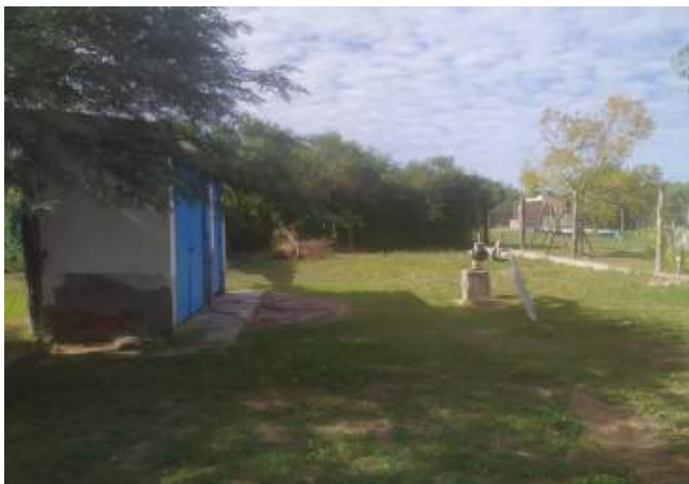
Foto 3 – Pozo de bombeo “Las Calandrias”.
