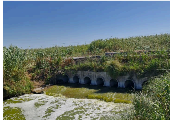
Imagen n°74: Estado actual de la alcantarilla A15 en funcionamiento (relevamiento propio).
