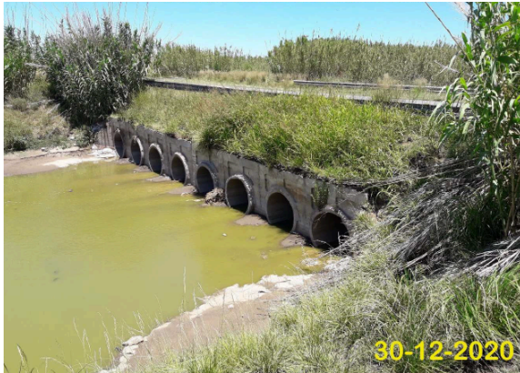
Imagen n°73: Estado de la Alcantarilla A15 [12].
