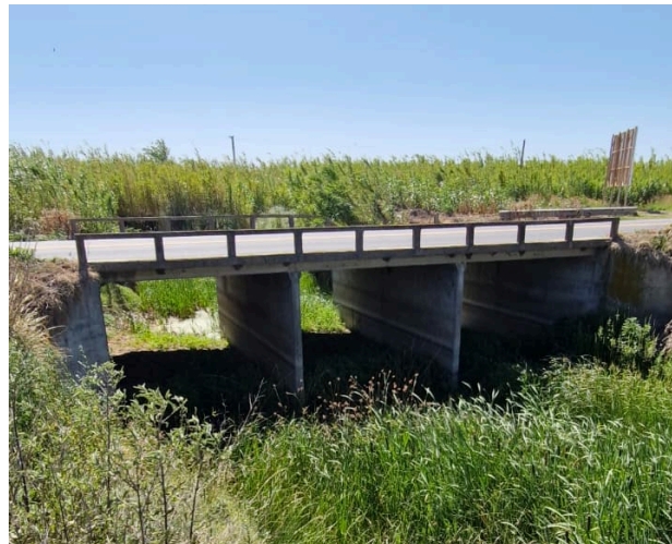
Imagen n°75: Estado actual de la alcantarilla A15 inutilizada (relevamiento propio).
