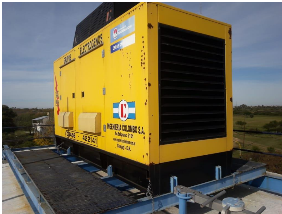
Figura 21: Grupo Electrógeno 600kVa, Toma de agua. Fuente: Elaboración propia
