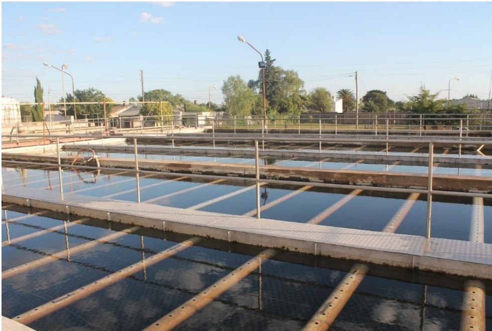
Figura 22: Decantadores. Planta potabilizadora Fuente: Elaboración propia
