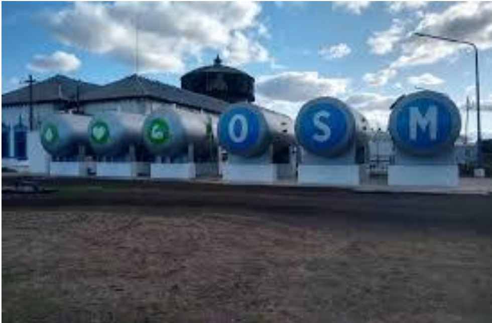
Figura 25: Filtros a presión. Planta potabilizadora Fuente: Elaboración propia
