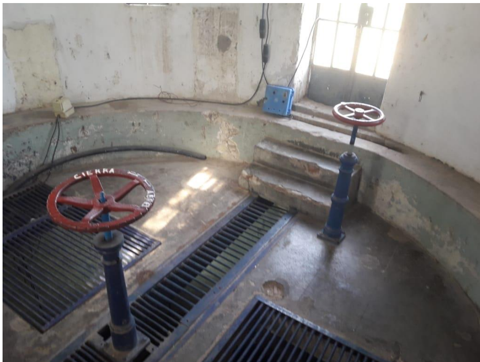
Figura 18: Válvulas correspondientes a las bombas de succión
