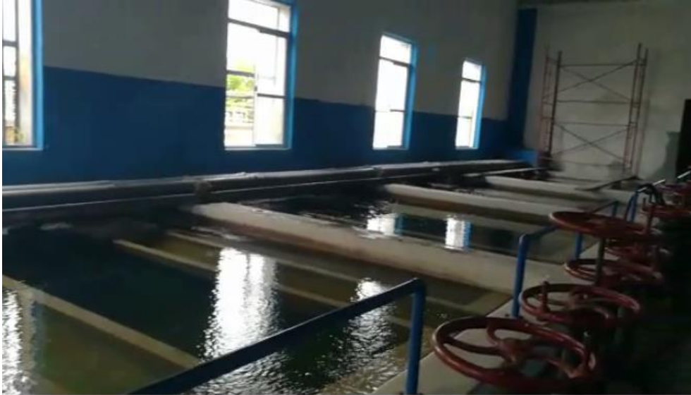
Figura 24: Filtros rápidos. Planta potabilizadora Fuente: Elaboración propia
