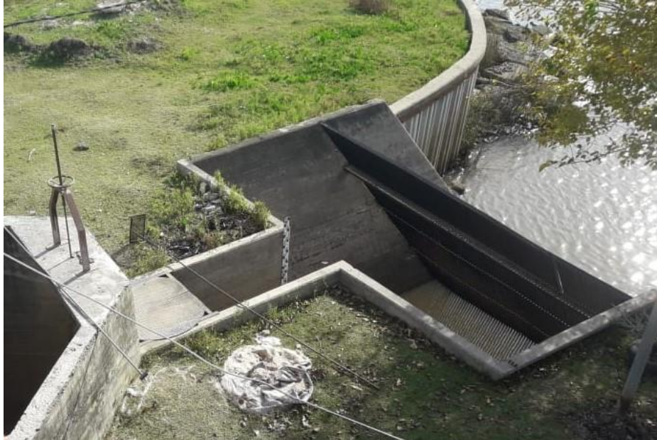
Figura 19: Fotografía de la captación superficial de agua DOSG. Fuente: Elaboración propia
