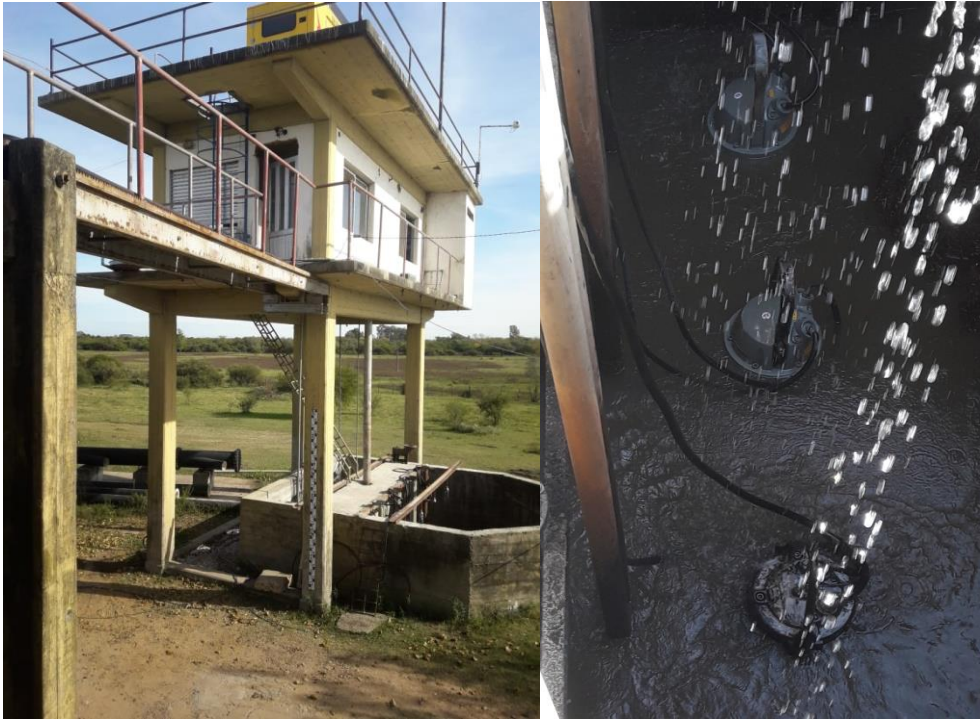
Figura 20: Toma de agua. Fuente: Elaboración propia
