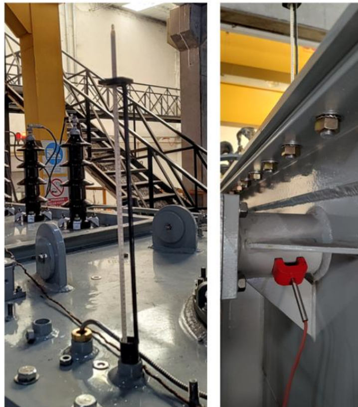
Figura 4-4: Elementos de medición de temperatura.
