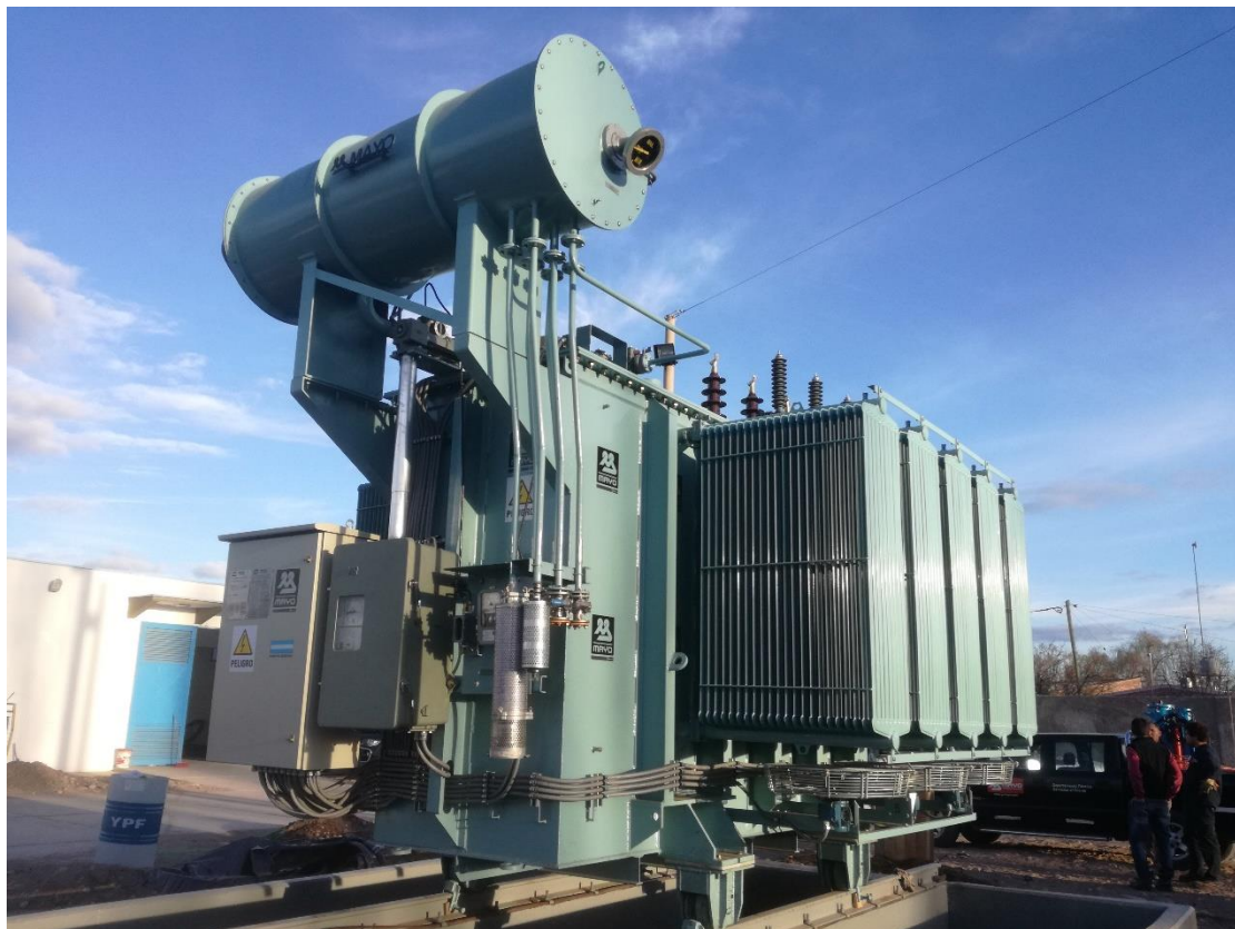
Figura 4-1: Transformador 91986 de SubTransmisión 20MVA 33 kV 13,86 kV
