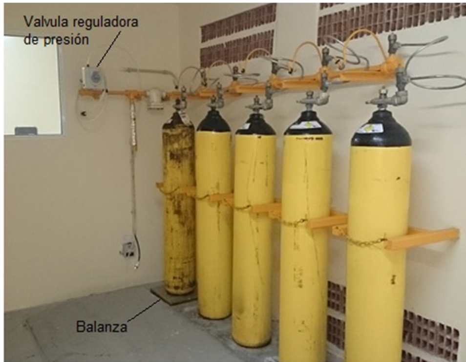
Figura 21: Batería de tubos conectada en paralelo estación de cloración
