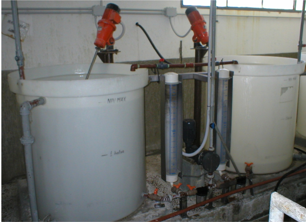
Figura 19: Tanques destinados a la preparación de las soluciones de sulfato de aluminio al 20 %
