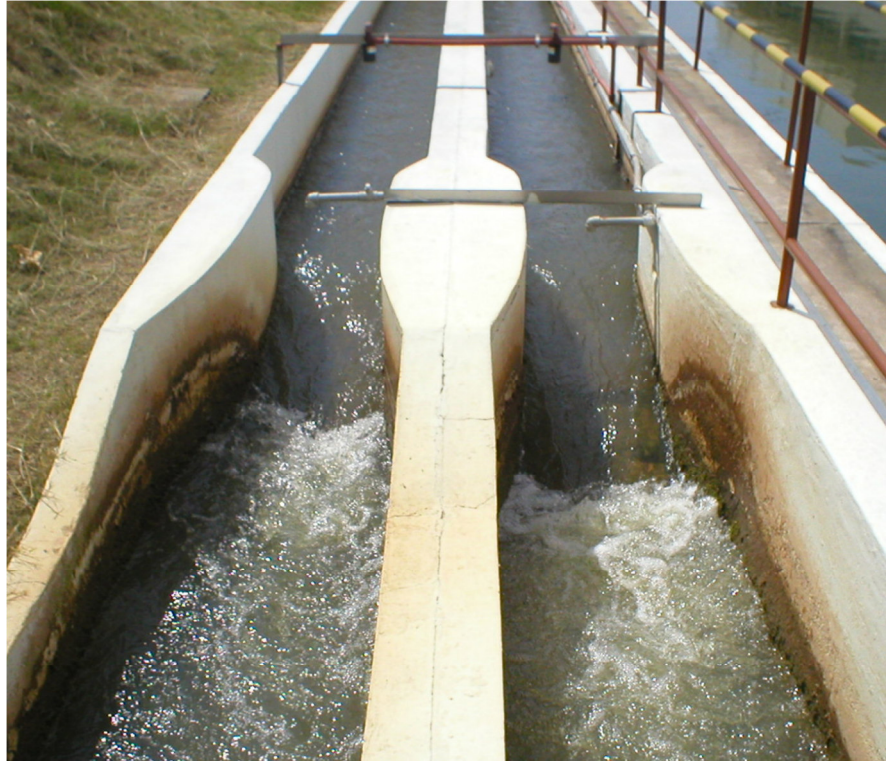
Figura 14: Canaletas Parshall módulo B
