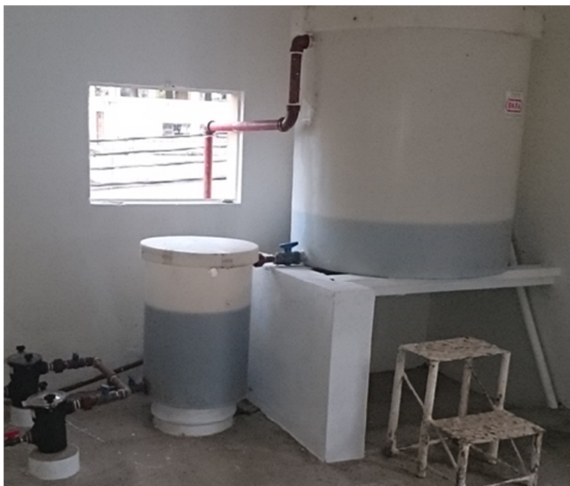
Figura 20: Instalación para la dosificación de PAC
