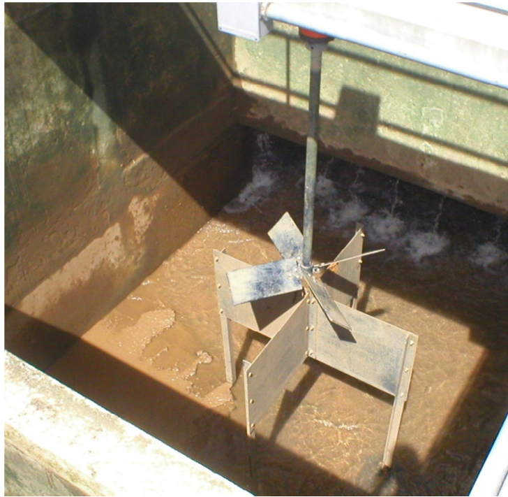
Figura 15: Floculador mecánico módulo B
