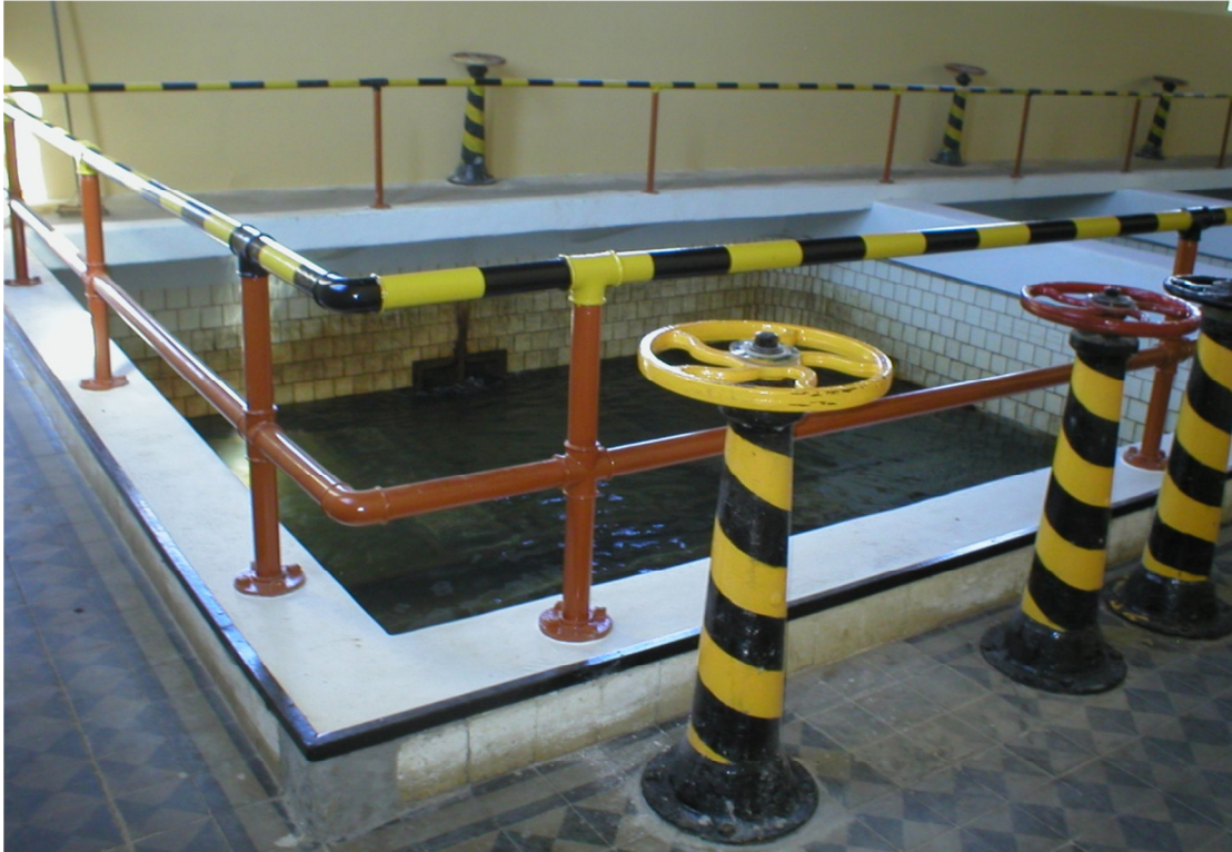
Figura 12: Sala de filtros rápidos módulo A
