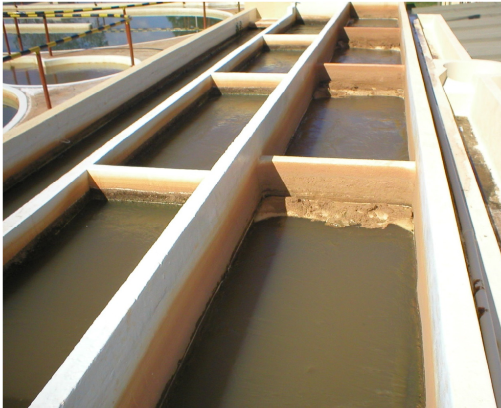
Figura 9: Floculador hidráulico módulo A
