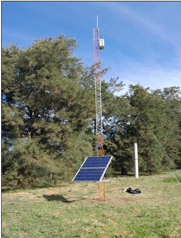
Figura 28: Nodo solar instalado en estructura autónoma.
