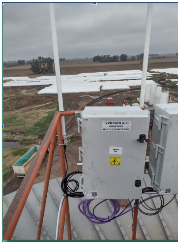
Figura 23: Instalación en noria vista aérea
