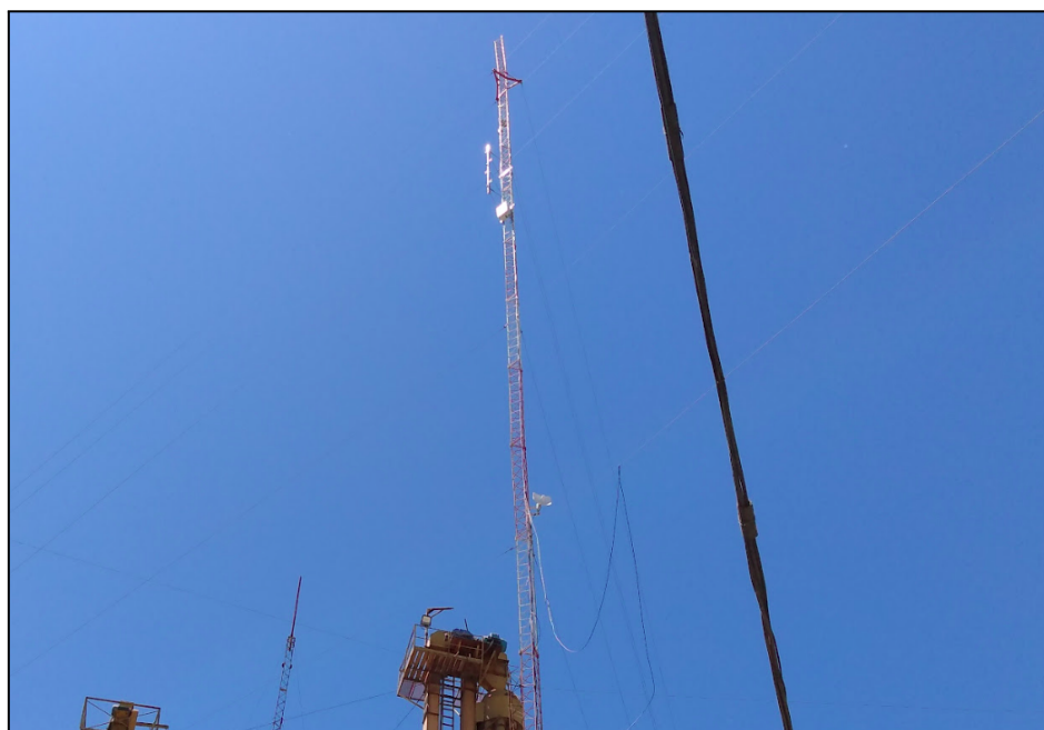
Figura 21: Nodo instalado en columna estructural a 30 metros de altura
