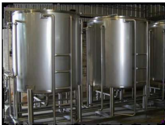
Figura 1-5: Tanques de estandarización de producto
